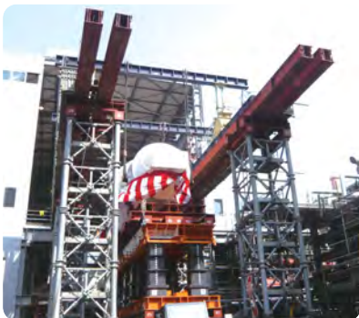
▲ガスタービン納入の状況
