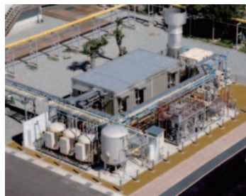
バイオガス都市ガス化設備東灘処理場
