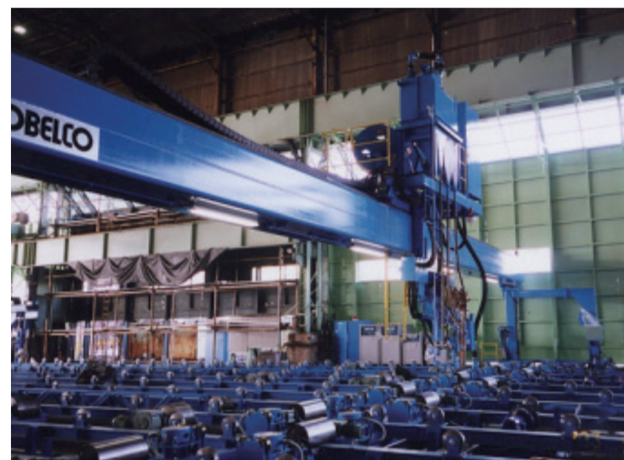
片面板継サブマージ 溶接装置
