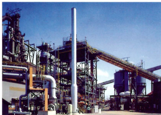
加古川製鉄所 第1号高炉のPCIシステム
