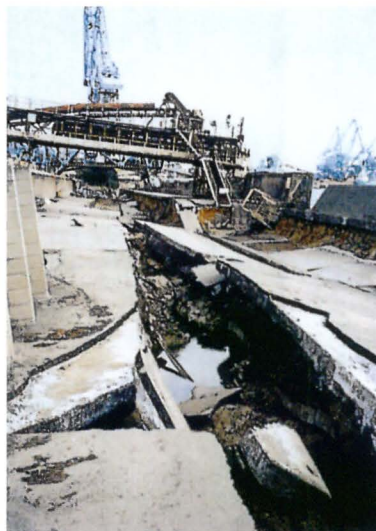
大きな被害を受けた神戸製鉄所の岸壁
