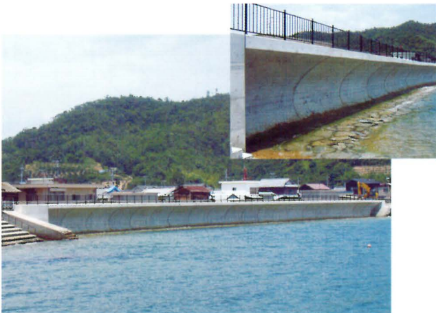
フレア護岸 台風時の越波が少なく景観にも優れる
