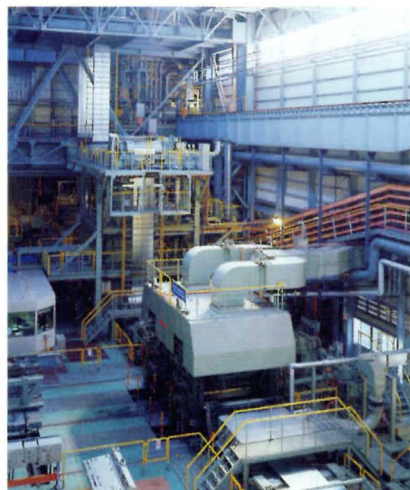
加古川製鉄所 No.2溶融亜鉛めっき設備 自動車用防錆鋼板の需要増に対応する
