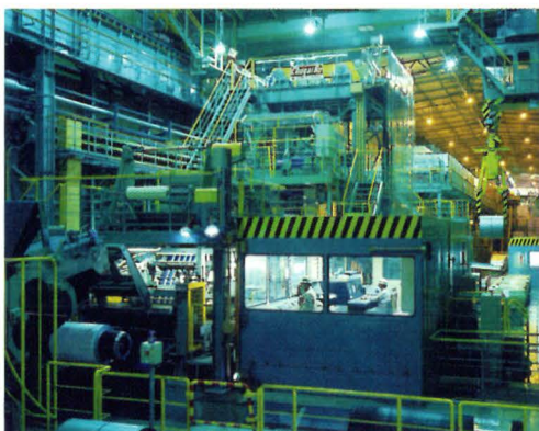
加古川製鉄所 No.2鋼板塗装設備 プレコート鋼板市場への本格参入を図る
