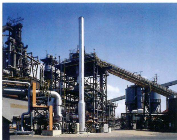
加古川製鉄所 PCI設備 微粉炭吹込み (PCI) 技術は当社の特長であり、操業中の全高炉に導入された
