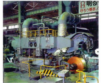
長府製造所 20段仕上げ圧延ミル
