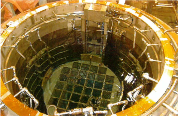
使用済燃料輸送容器保守施設 (f3) バスケット外面除染装置
