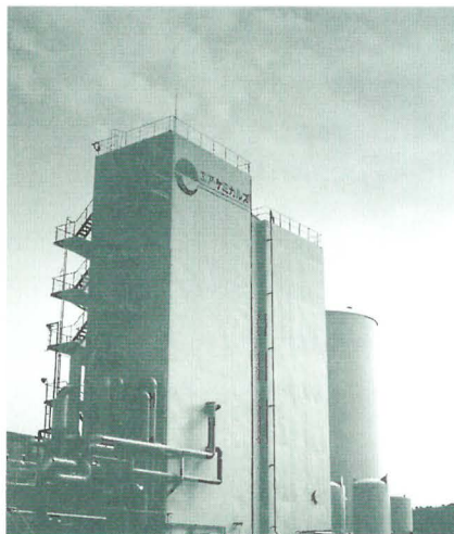
夜間電力利用型空気分離装置 夜間時間帯に液化循環システムを自動起動して液体酸素・窒素を製造し、電気代の高い昼間時間帯になると自動停止させることで従来比2割ダウンのコスト低減を実現
