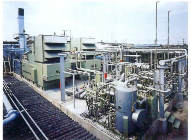
コジェネレーションシステム
