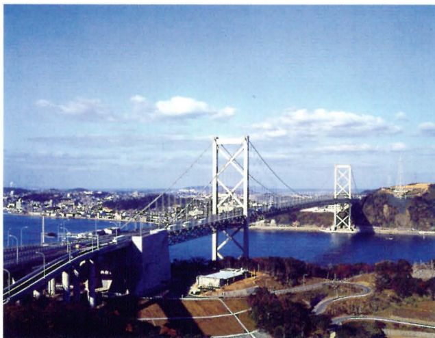
関門橋のメインケーブル架設工事を施工 パラレル・ワイヤ・ストランド法（PWS）が採用（1971年）
