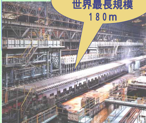
熱延冷却設備
