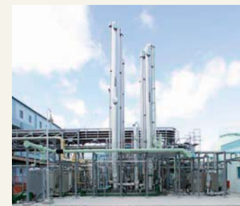
バイオ天然ガス化設備
