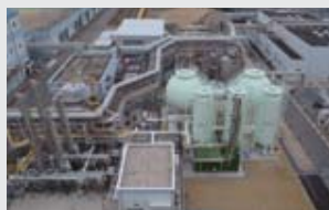
KOBEGREEN・スイーツプロジェクトの実証設備(神戸市建設局提供)
