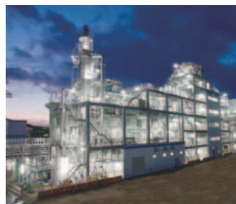
兵庫西流域下水汚泥焼却処理場
