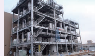
琵琶湖流域下水道湖南中部浄化センター
