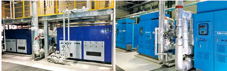
設置されたスクリー式発電機とバイナリー発電機
