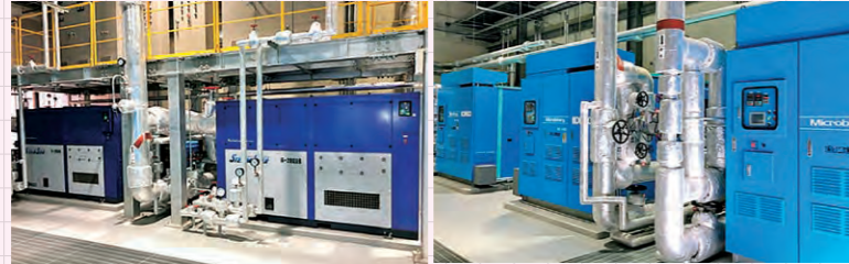
設置されたスクルー式発電機とバイナリー発電機
