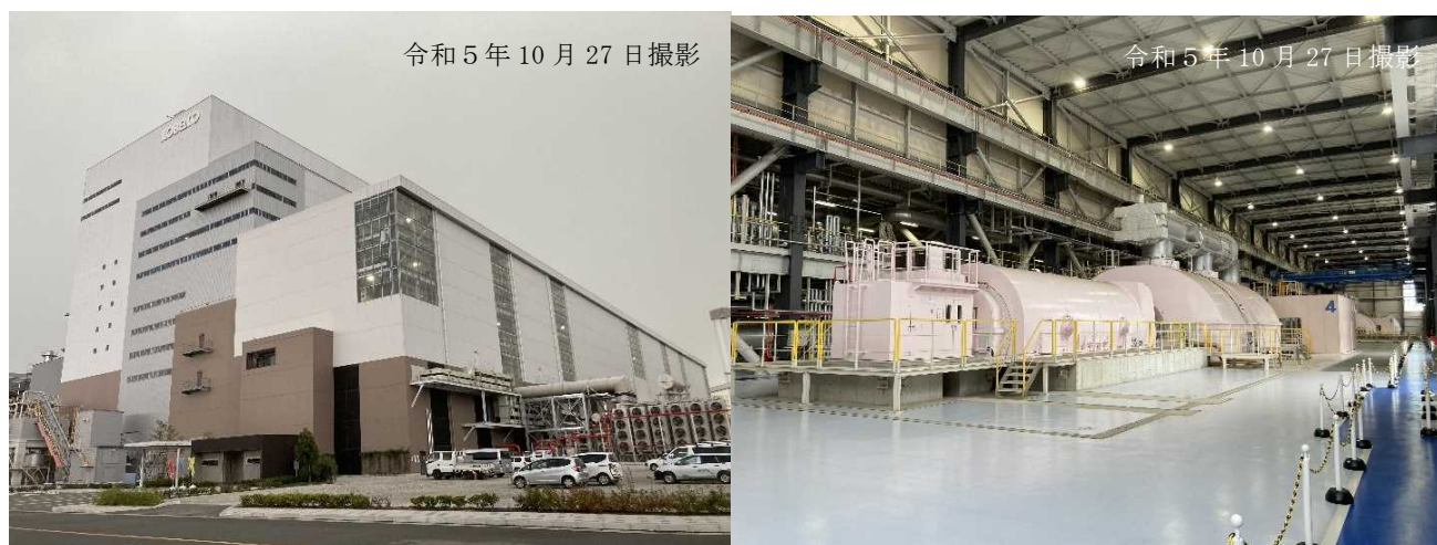
写真4.2-1(1) 騒音発生機器、振動発生機器及び低周波音発生機器の状況 (左図：ボイラー防音囲い・タービン建屋 右図：蒸気タービン、発電機の屋内収納及び強固な基礎上の設置)
