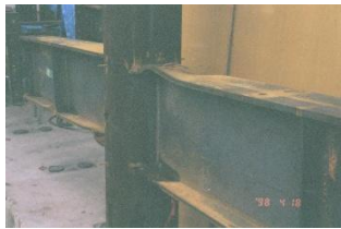
破壊状況(梁の局部座屈)*3
