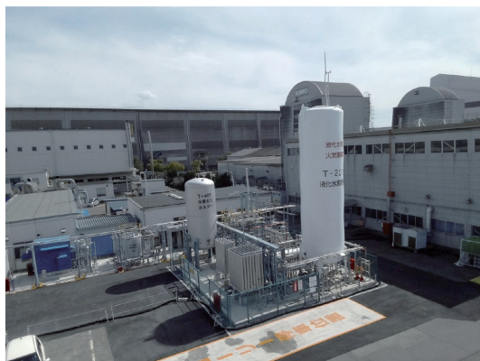
図4 LH 2 気化実証設備の全景
