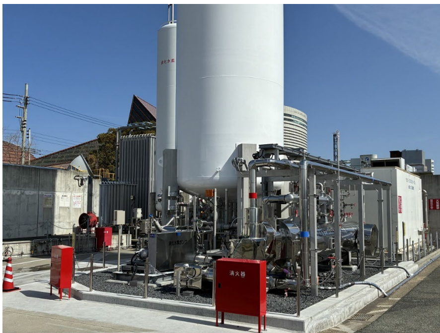
実証設備（神戸市ポートアイランド地区内神戸水素エネルギーセンター）
