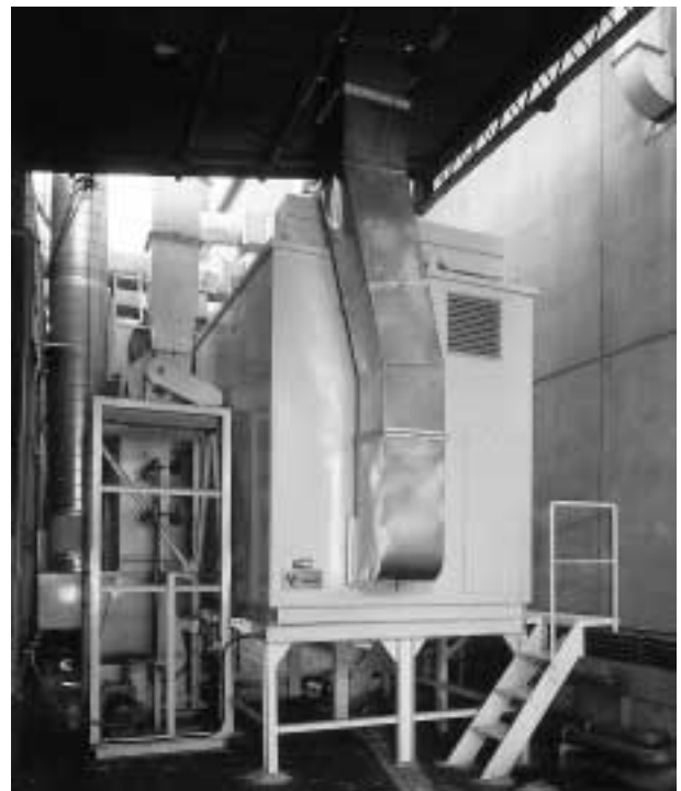
写真1 脱臭装置の外観
