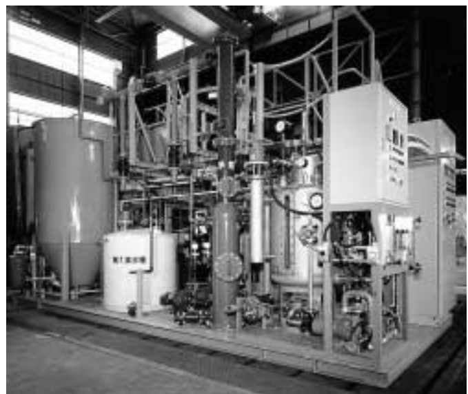
写真1 フロン分解処理装置の外観
