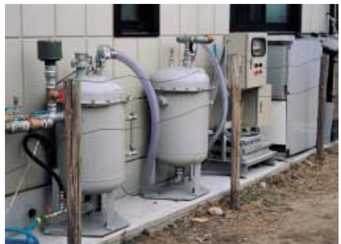
写真1 土壌浄化装置の外観
