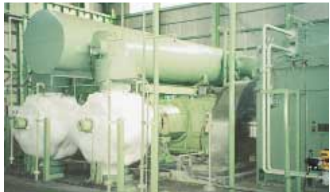
写真 1 LNG BOG 圧縮機の外観
