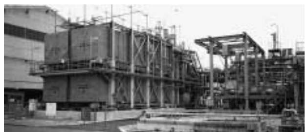
写真 1 BOG 再液化システム全景 Photo.1 Facility of BOG re-liquefaction
