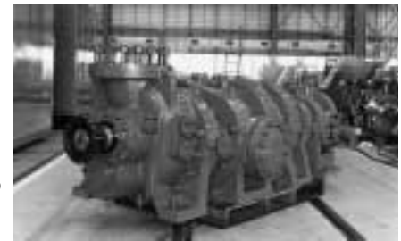
写真1 圧縮機本体の 外観
