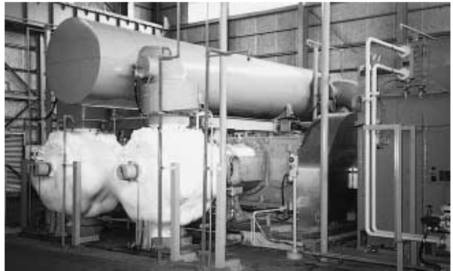
写真2 LNG BOG 圧縮機 Photo 2 Overview of LNG BOG reciprocating compressor
