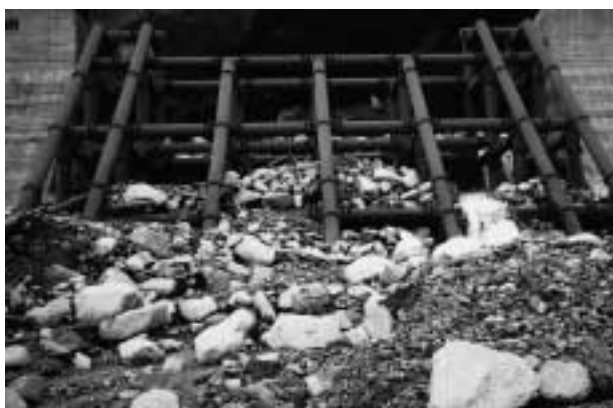
写真1 堆砂状況（大柵沢第2砂防ダム） Photo 1 State of sediment (The second dam in Ohtanazawa)
