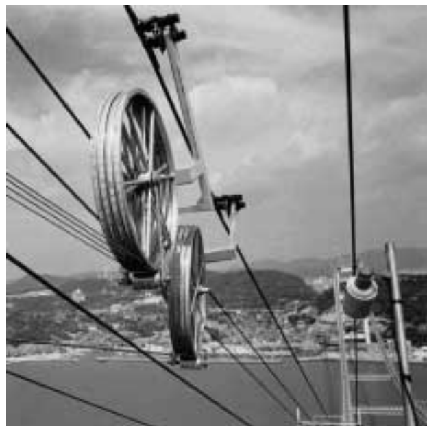
写真 1 AS 工法によるケーブル架設 Photo 1 Cable erection by air-spinning method
