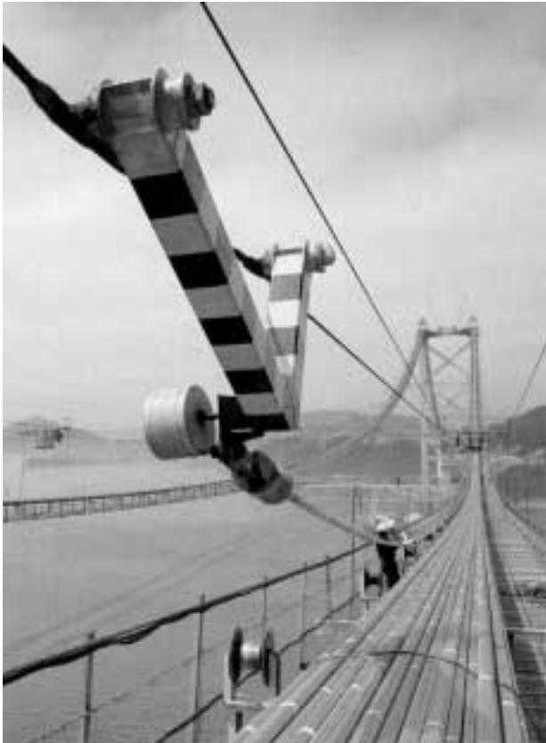
写真2 PWS工法によるケーブル架設 Photo 2 Cable erection by PWS method
