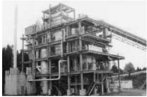
写真1 実証プラント Photo 1 Demonstration plant
