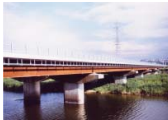
写真3 海浜・海岸耐候性鋼を適用した橋梁の一例(架設後2年経過)
