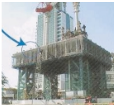
b) スーパーメガフレーム完成状況 b) Erection of super mega-frame
