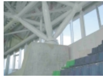
b) 支承下部ノード,トラスノード組込み状況 b) Erection of bearing bottom node and truss node
