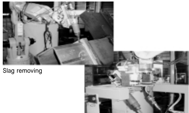
写真3 スラグ自動除去装置
