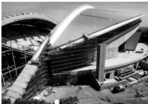
写真3 神戸ウィングスタジアムに採用された制振アルミ屋根 Photo. 3 Aluminum roof with resin adopted for "Kobe Wing Stadium"
