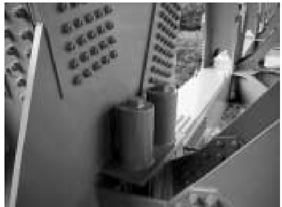
写真4 アンカボルト防錆キャップ Photo 4 Rust prevention cap of the head of anchor bolt
