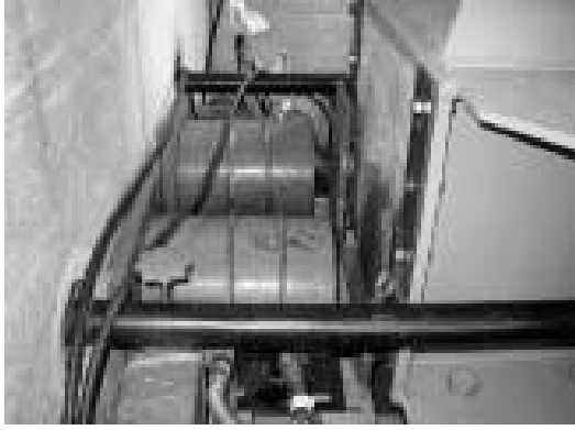
写真6 急速解放ジャッキ設置状況 Photo 6 Installation of rapid relief jacks
