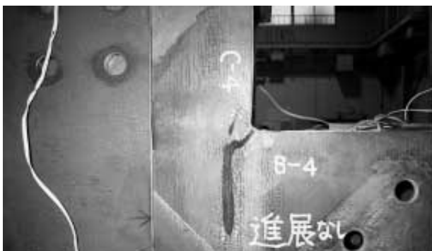
写真4 熱プレストレス補強 ( C_p ) の試験後 Photo42 Fatigue crack of C_p specimen
