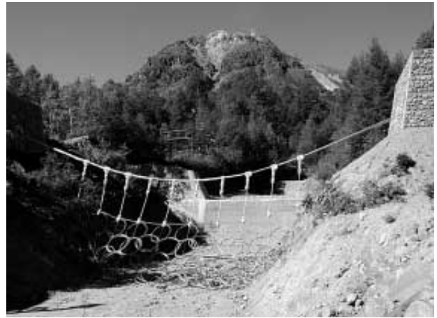
写真7 上々堀沢に完成した改良式ワイヤネット工 Photo 7 New wire net dam at Kamikamihorisawa
