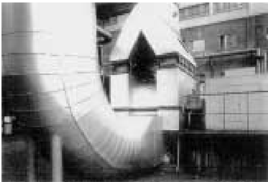
写真6 防音ラギング Photo 6 Soundproof lagging
