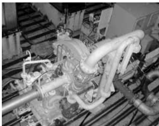
写真1 燃料ガスターボ圧縮機の外観
