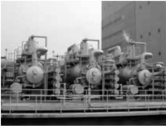
写真1 蒸気発生器の外観 Photo 1 Externals of steam generator
