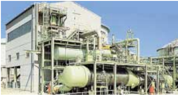
写真1 冷熱発電設備（大阪ガス㈱） 1) Photo 1 LNG cold power generation plant (Osaka Gas. Co., Ltd.) 1)
