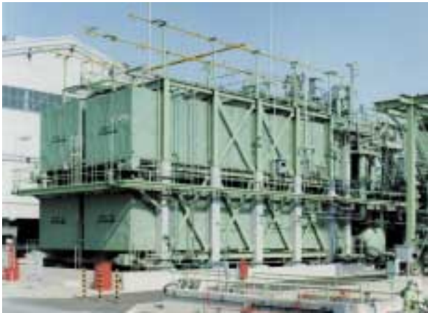
写真2 BOG再液化設備（大阪ガス㈱） 2) Photo 2 BOG re-liquefaction plant (Osaka Gas. Co., Ltd.) 2)
