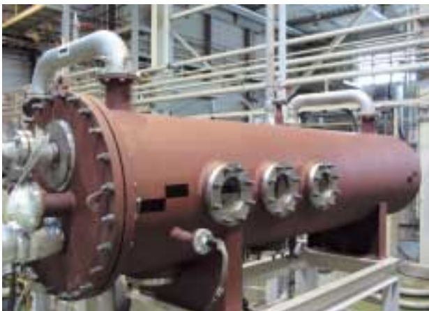
写真3 実証試験装置 Photo 3 Pilot plant
