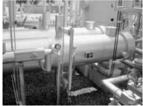
写真4 運転中の円筒型温水バス式気化器外観 Photo 4 Hot water bath vaporizer in operation
