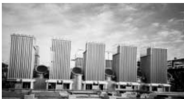
写真1 自然通風型空温式気化器（消霧装置付帯）の外観
