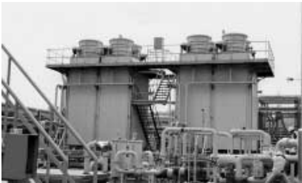
写真2 強制通風型空温式気化器の運転中の外観 Photo 2 Forced draft vaporizer in operation
