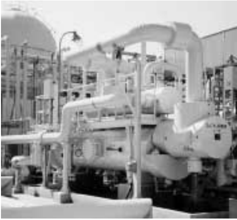
写真5 運転中の温水 TRI-EX 式気化器外観 Photo 5 Intermediate fluid type vaporizer (IFV) in operation
