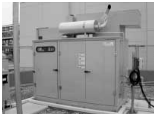
写真2 ガスエンジンコージェネレーションユニット Photo 2 Gas engine combined heat and power system
