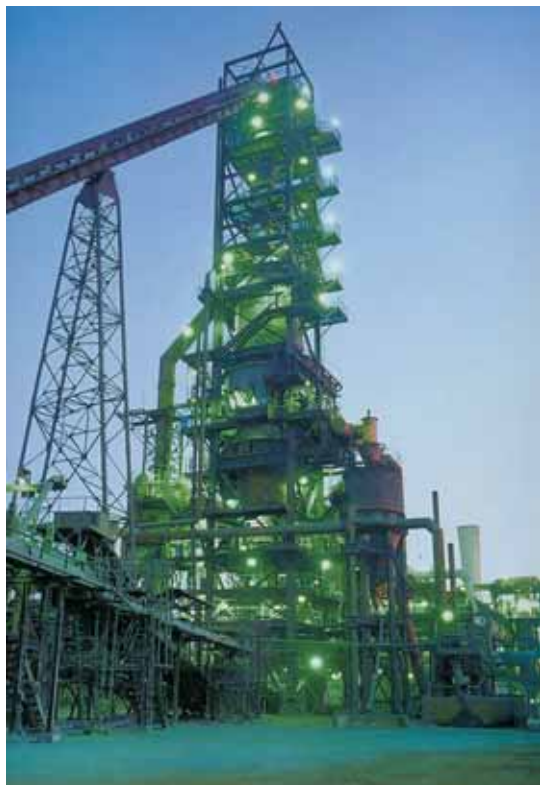
直接還元鉄プラント
