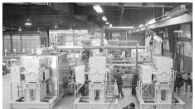
写真1 燃料ガス圧縮機の外観
