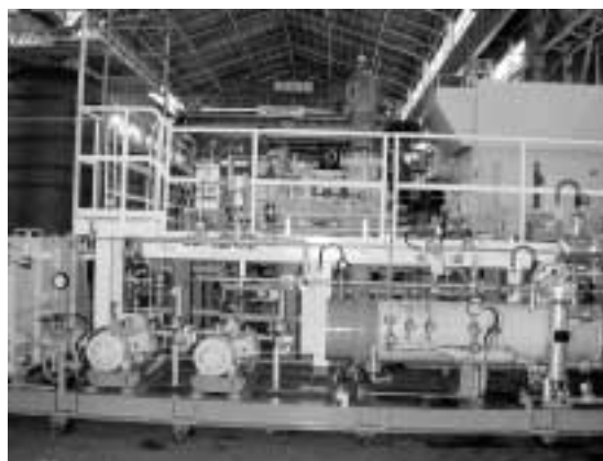
写真 2 脱硫圧縮機ユニットの外観
