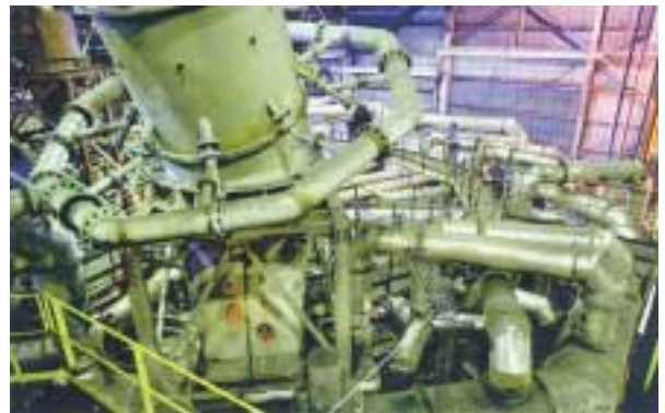
写真4 実証プラントの還元溶融炉 Photo 4 RHF in demonstration plant of ITmk3
