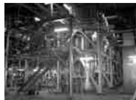
写真1 ボイラ設備全景
