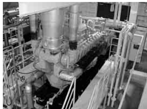
図2 ガスエンジン Fig. 2 Gas engine generator
