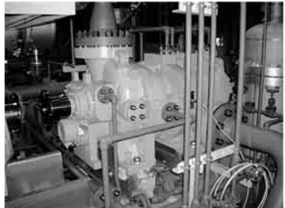
写真 1 圧縮機本体外観
