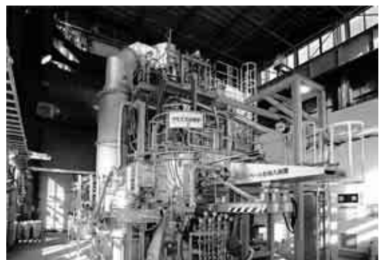
写真1 実証試験設備 Photo 1 Overview of test plant
